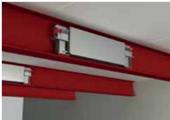
Schwingungstilger im eingebauten Zustand © KTI Schwingungstechnik GmbH
