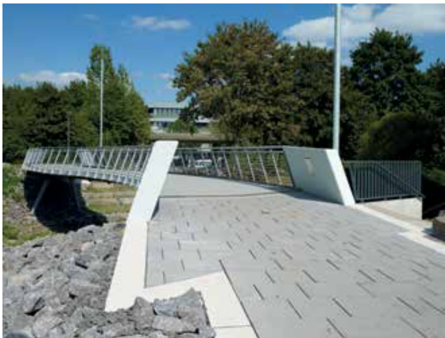
12 Wartungsarme Konstruktion als Resultat © Tom Gundelwein
